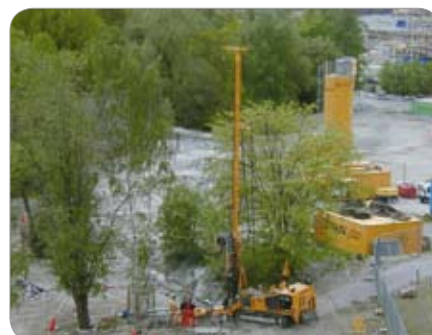
Södra Länken, Stockholm – Sweden Ground water infiltration prevention at Södra Länken high-way link.
